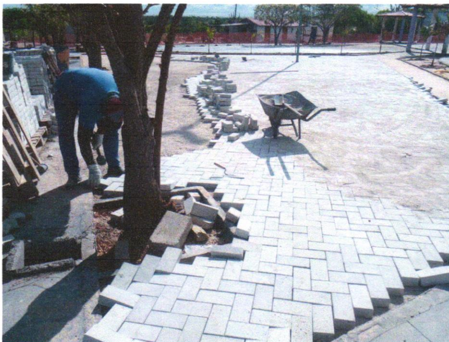
Foto 05 - Pavimentação em bloco de concreto vibroprensado, intertravado, cor natural, 10x20cm, e=6cm, 46un/m 2 , NBR9781, Fck(min)=35MPa, sob coxim areia grossa compactada c/ placa vibratória, e(comp.)=6cm, rejuntado c/areia fina.
